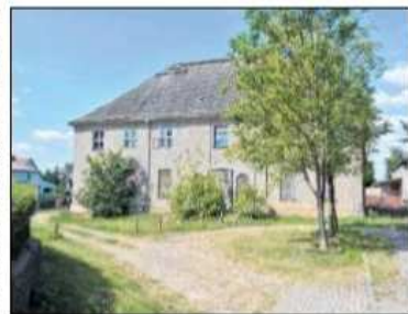
Spiegelte eine zentrale Rolle in Ribbecks Geschichte: Das mittlerweile verwaiste Gutshaus, das zunehmend zerfällt.
